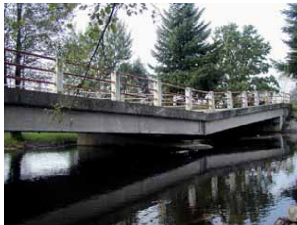
Obr. 4 Fotodokumentace poškozeného mostu u obce Šipoun
