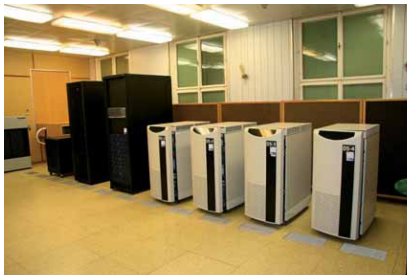
Obr. 1 Sál datového úložiště s úložnými systémy ze stávajících datových center resortu
