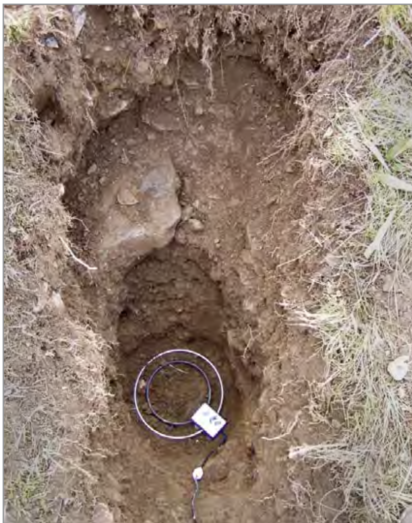
Obr. 3 Instalace čidla vlhkosti půdy VIRRI v hloubce 0,9 m
